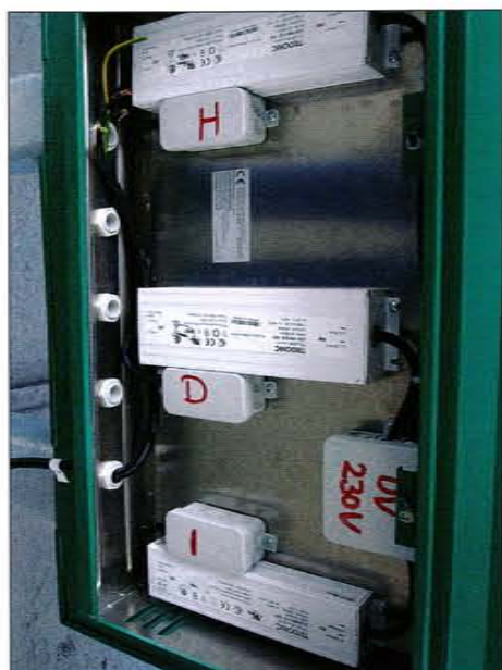
Der elektrische Anschluss füllte den dritten Tag. Die Konverter wurden in externen Trafoschutzkästen installiert.
